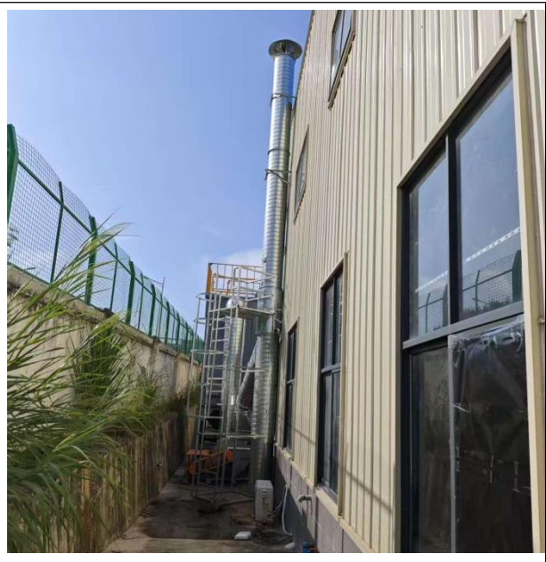
废气处理设施
